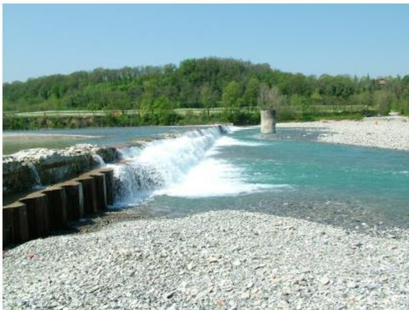
Figura 4.7.1 - Vista della galleria filtrante di Mirafiori a monte di Case Buschi (da Studio ambientale)
